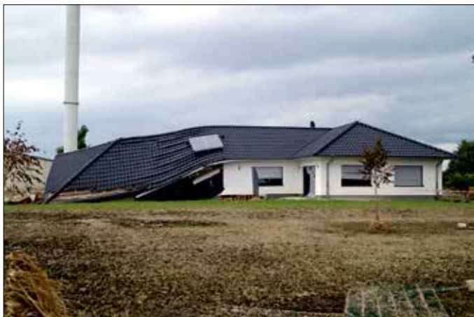
Dieses Haus hielt den Wassermassen nicht stand
